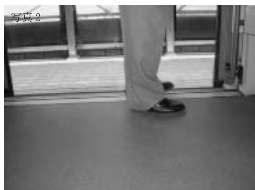
写真2 グリーンムーバー扉部分
